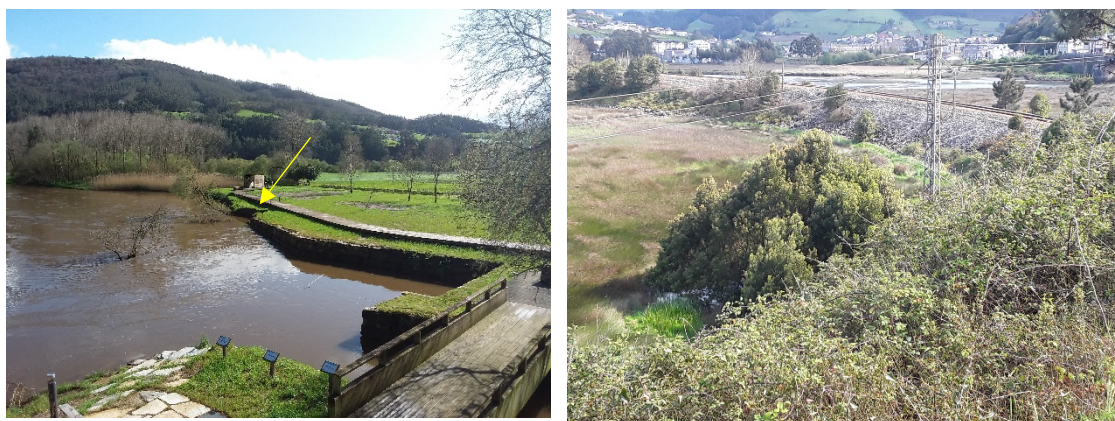
Figura 5.2.1. A la izquierda escollera de protección de orilla en el río Eo en Trabada (Lugo), con una erosión justo aguas arriba de la misma (flecha amarilla) y a la derecha ocupación de la llanura inundable por un relleno antrópico asociado a la línea de ferrocarril en Ribadeo y que está alterando los patrones de la inundabilidad que pueden darse ante condiciones naturales.
